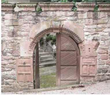
fachgerechter Ausbau und Ersetzen der historischen Bauteile durch vereinfachte Elemente Bamberger Natursteine 2014
